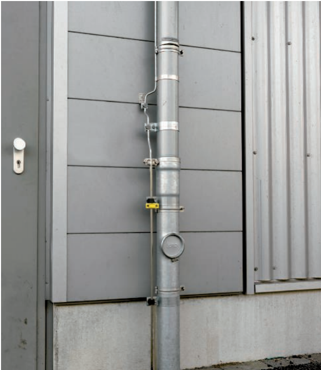
Blitzschutzableitung an einem Regenfallrohr
